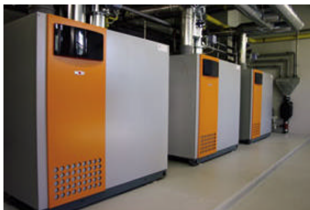
Wolf Gasbrennwert-Mittelkessel MGK in Kaskade geschaltet
